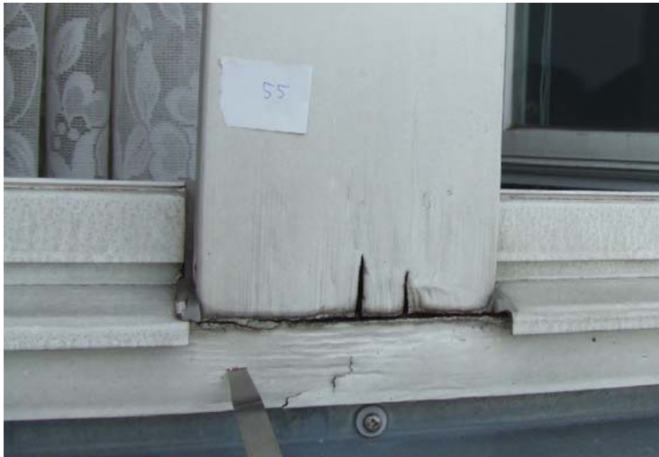
Abbildung 3: Pfostenanschluss mit Fäulnis. Erkennbar sind die defekten Endkappen, welche zu der Durchfeuchtung geführt haben.
